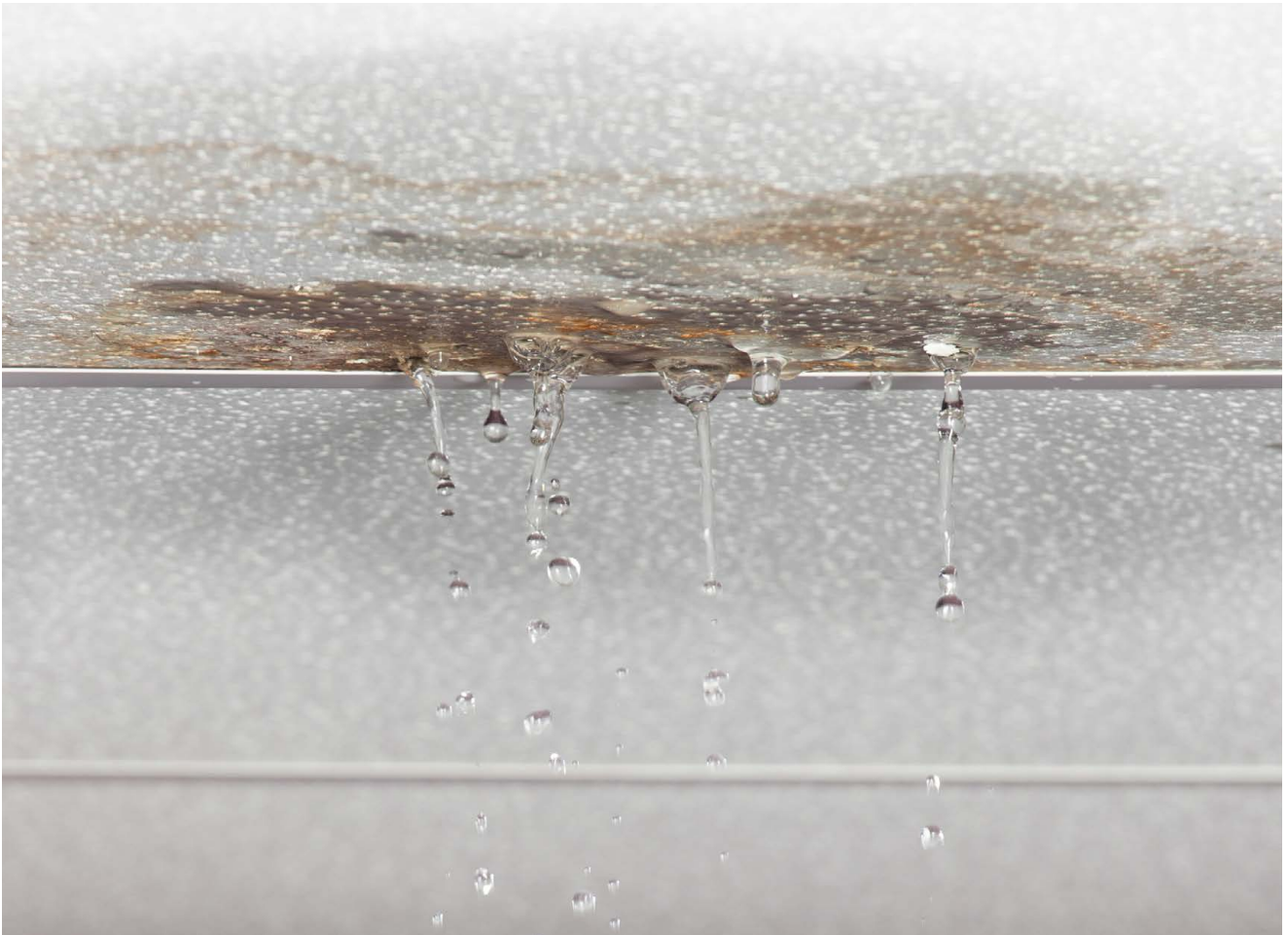
Deckenschaden durch auslaufendes Leitungswasser
