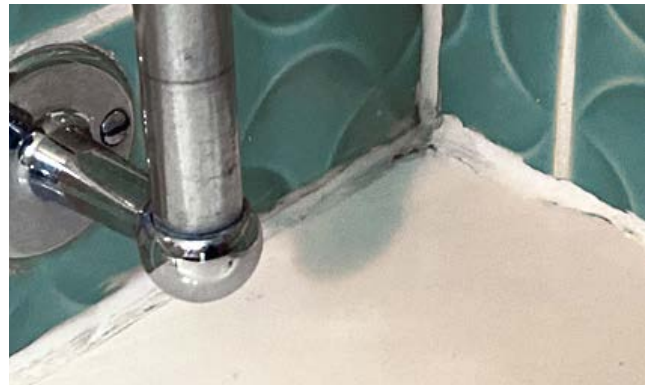
Teils undichte Dehnungsfuge Badezimmer
