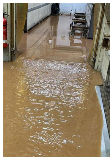
Überflutungsereignis in einem Gewerbebetrieb. Quelle: Feuerwehr Aura
